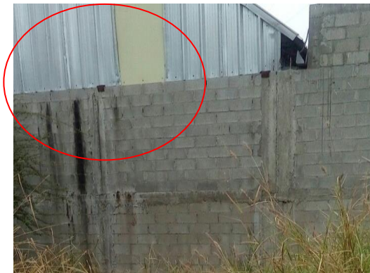
Figura 12: Pista de grasa en paredes
