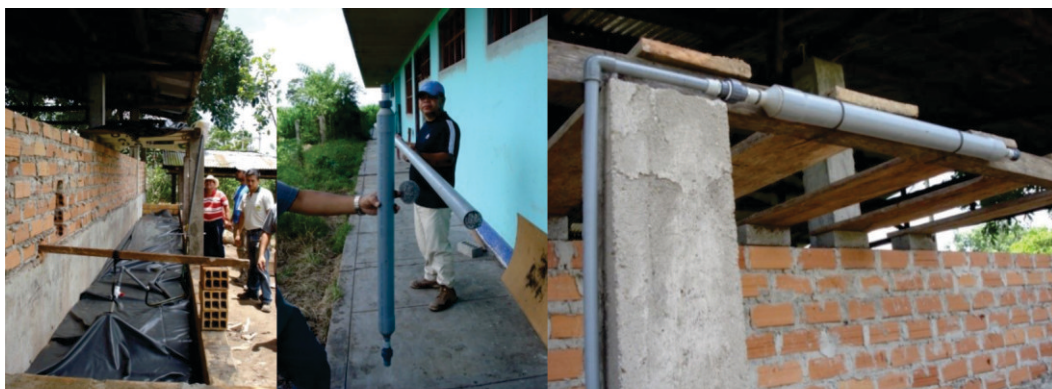
Figura 71. En el punto de salida de biogás del biodigestor se colocó una llave de paso de plástico de 1/2", la que se conectó con tubería y accesorios de PVC de 1/2" con el cartucho para eliminar el H 2 S.
