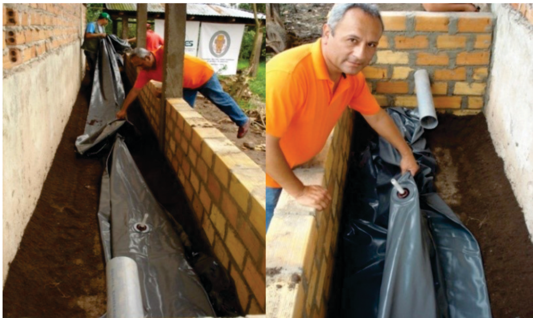
Figura 50. Colocación del biodigestor hecho de geomembrana de PVC en la poza. Accesorio para salida de biogás del biodigestor.
