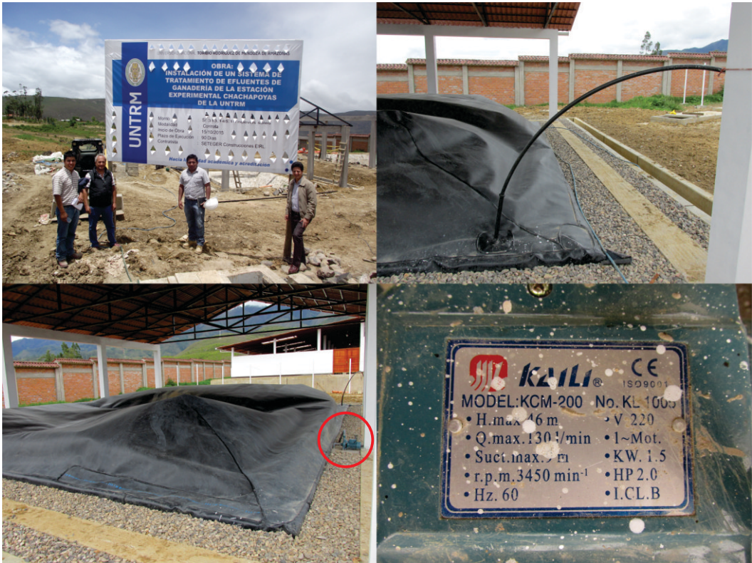
Figura 165. Cartel de obra. Salida de biogás del digestor. Electrobomba de 2 hp para recircular el sustrato en fermentación dentro del digestor.
