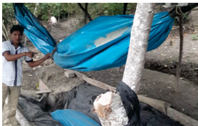
Figura 44. Ajuste de la parte central del balón de almacenamiento de biogás con una soga para aumentar la presión y la llama en la cocina.
