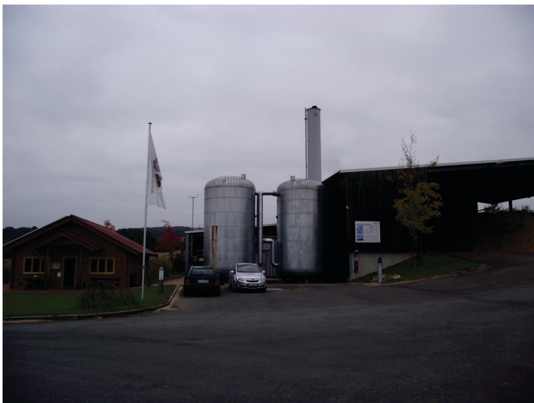
Figura 151. Tanques de almacenamiento de agua caliente para calefacción.
