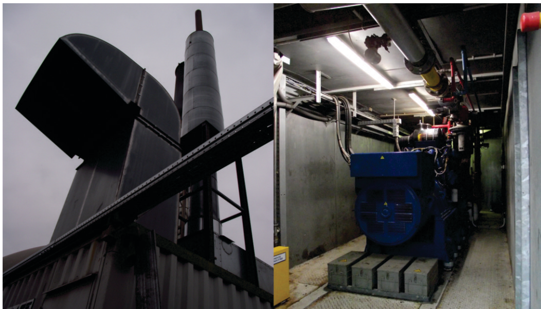
Figura 148. Ducto de ventilación y tubo de escape del motor del grupo eléctrico de 16 cilindros a biogás.
