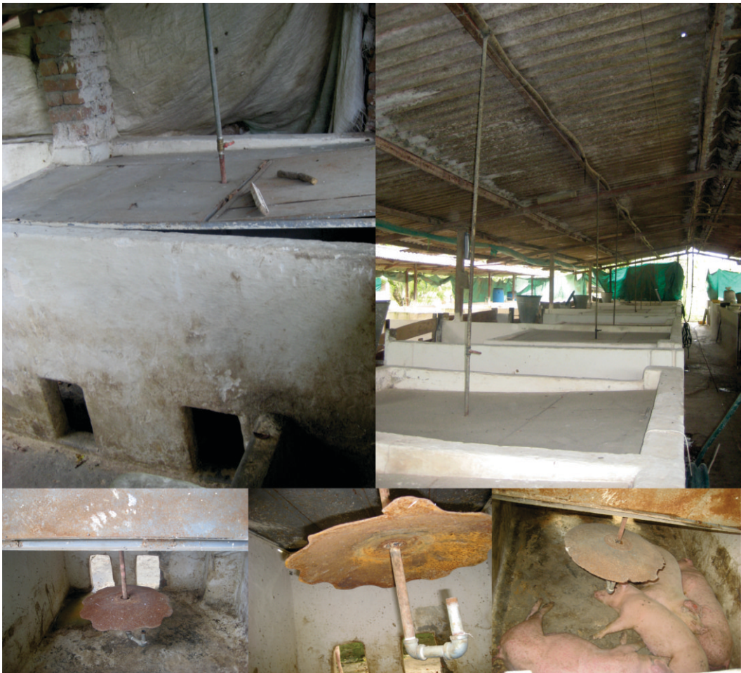
Figura 131. Calefacción a biogás para lechones en la Granja Pozo Verde.
