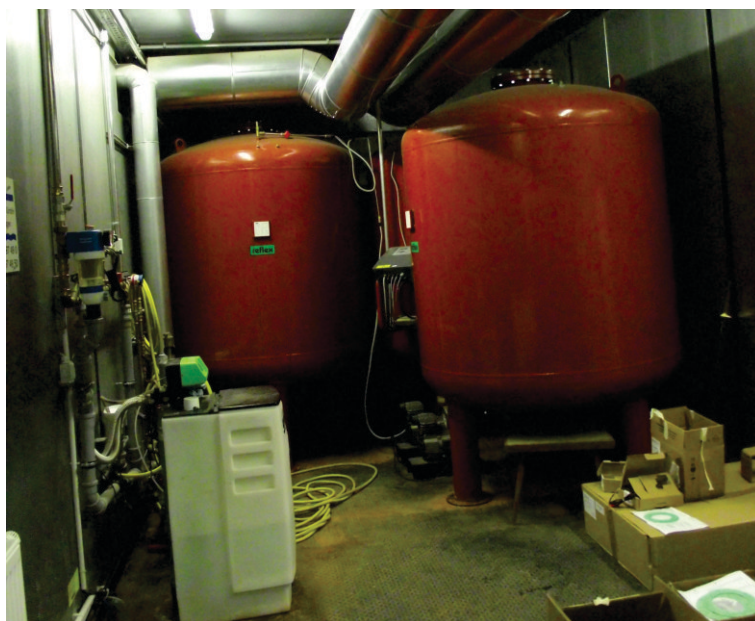
Figura 156. Tanques para compensar la presión en el sistema de abastecimiento de agua para calefacción del pueblo de Jühnde.
