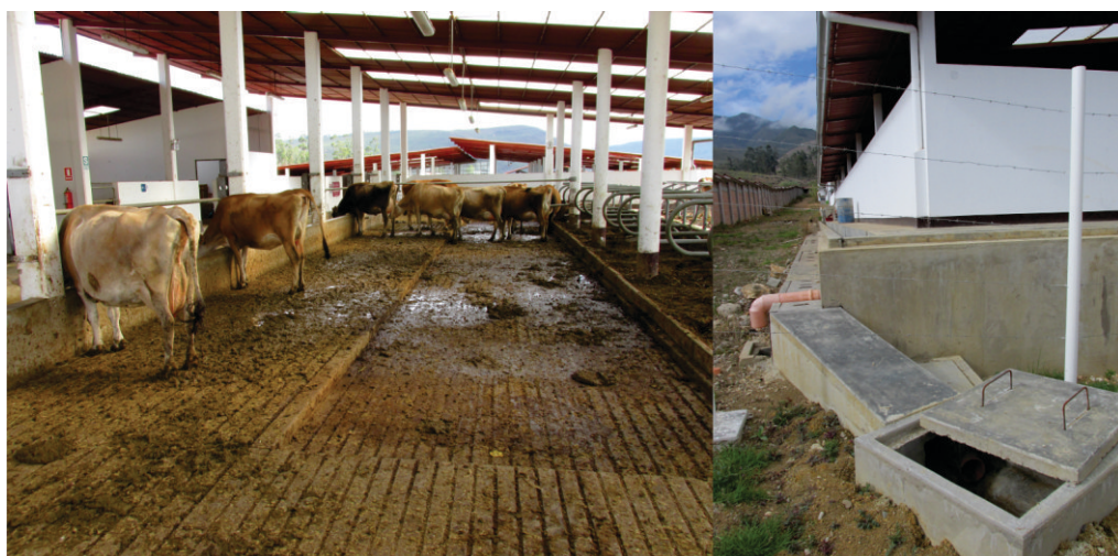
Figura 176. Piso del establo de la UNTRM y canaleta de conducción de la mezcla estiércol:agua al sedimentador.
