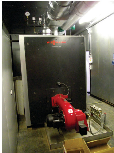
Figura 154. Caldera a petróleo para atender en caso de mayor demanda de agua caliente para calefacción.
