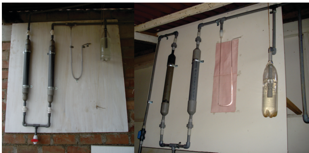
Figura 23. Tablero con componentes para eliminación de agua y medición y control de presión del biogás.
