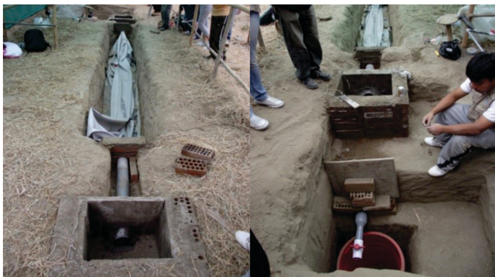
Figura 64. Poza de carga, poza con el biodigestor, poza de descarga de biol y más abajo salida para biosol; del biodigestor de la UNT.
