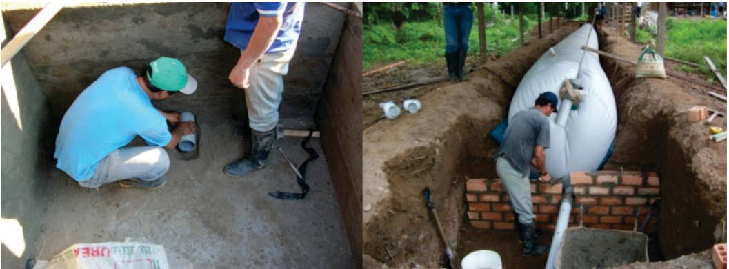
Figura 68. Poza de carga y construcción de la poza de descarga del biodigestor.
