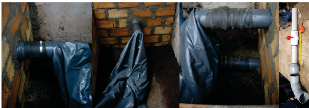
Figura 52. Conexión del biodigestor a las pozas de carga y descarga. Al fondo para drenaje total, que termina en la reducción y llave de paso de 2".
