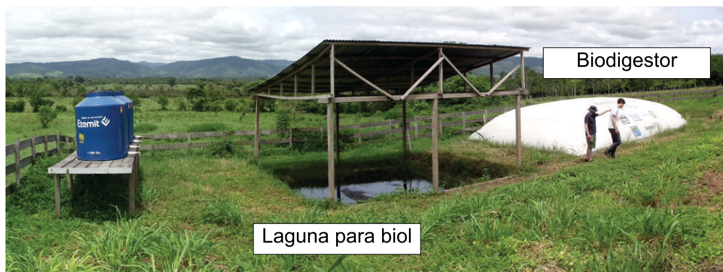
Figura 28. Biodigestor laguna cubierta instalado en la Estación El Porvenir del INIA en Tarapoto.
