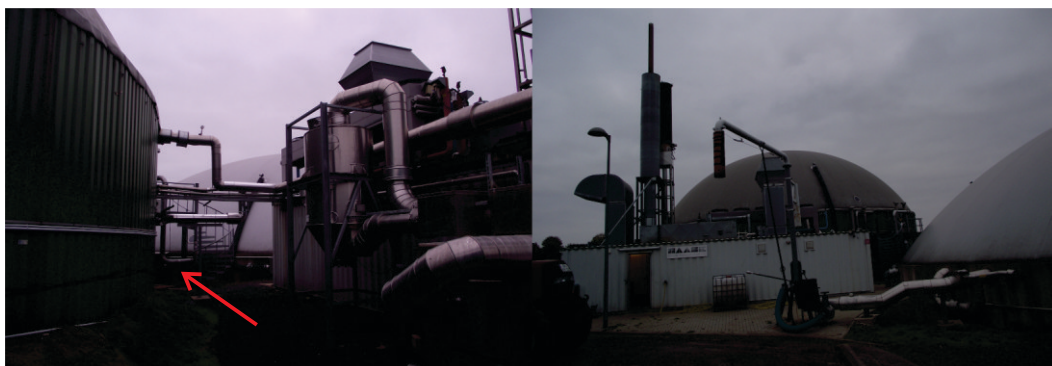
Figura 149. Tubería que conduce el digerido (biol) al tanque de almacenamiento. Sistema de bombeo de biol al tanque para su dispersión en el campo.
