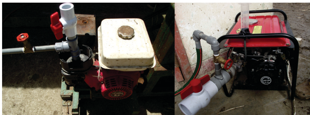
Figura 110. Dispositivo para hacer funcionar el grupo electrógeno de 1 kW; y otro para hacer funcionar el motor de 9 hp de la picadora de pasto. Ambos a biogás.
