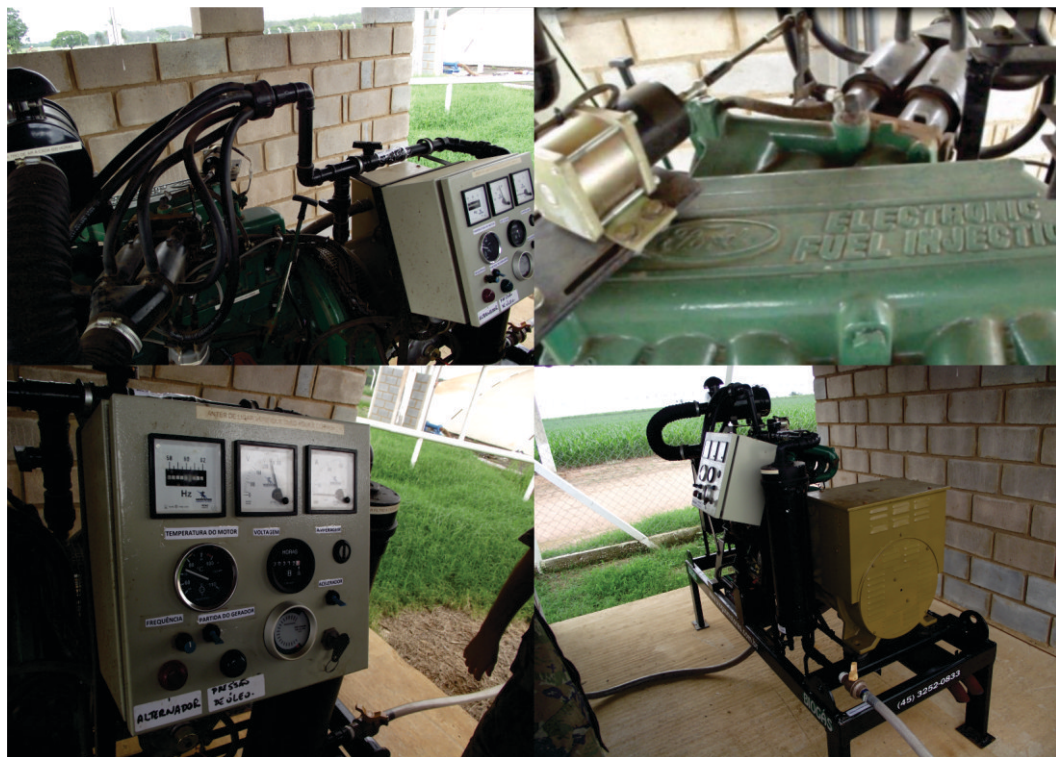
Figura 114. Motor Ford de 6 cilindros a biogás acoplado a generador eléctrico de la granja de cerdos de la Hacienda de la FAYS en Pirassununga.
