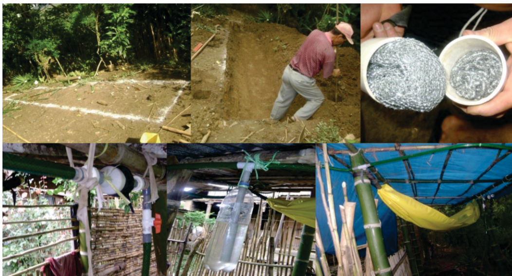
Figura 41. Trazado para excavar la poza de fondo curvo para el biodigestor de manga de polietileno en San Juan de Ocumal (Amazonas). Cartucho para eliminar el H_2S . Regulador de presión del sistema. Balón para almacenar el biogás.
