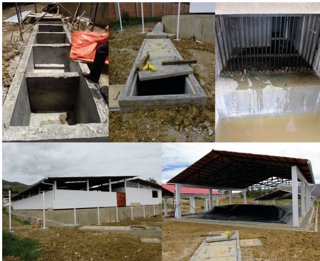
Figura 172. Sedimentador ubicado entre el establo y el digestor.
