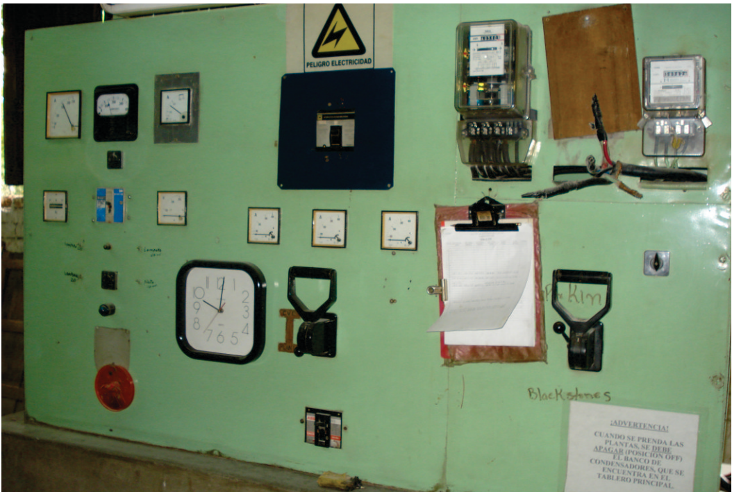
Figura 106. Tablero de control de la energía eléctrica generada por los grupos electrógenos de la Granja Pozo Verde, Cali – Colombia.
