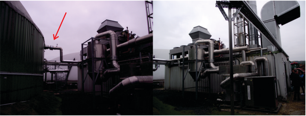
Figura 147. Tubería que conduce el biogás al sistema de purificación para ser empleado como combustible del grupo electrógeno.
