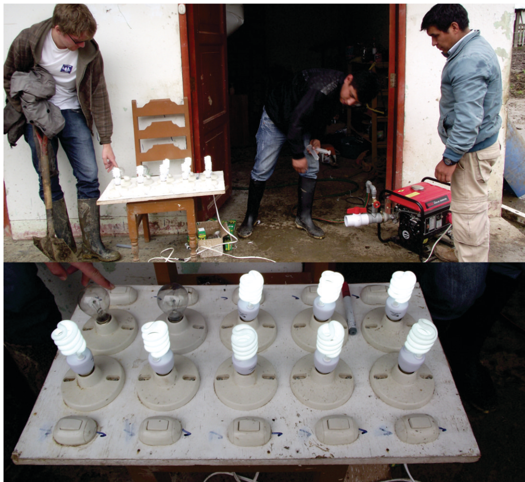
Figura 109. Grupo electrógeno a biogás en Pomacochas. Hace funcionar 8 focos ahorradores de 18 W.
