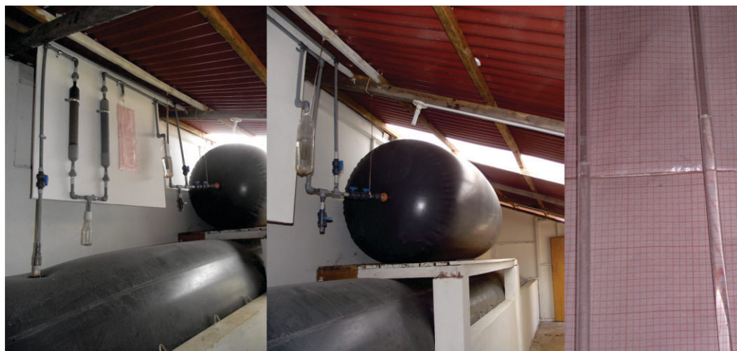
Figura 95. Biodigestor instalado en el Campus de la UNTRM, operando a 4 cm de presión de agua.
