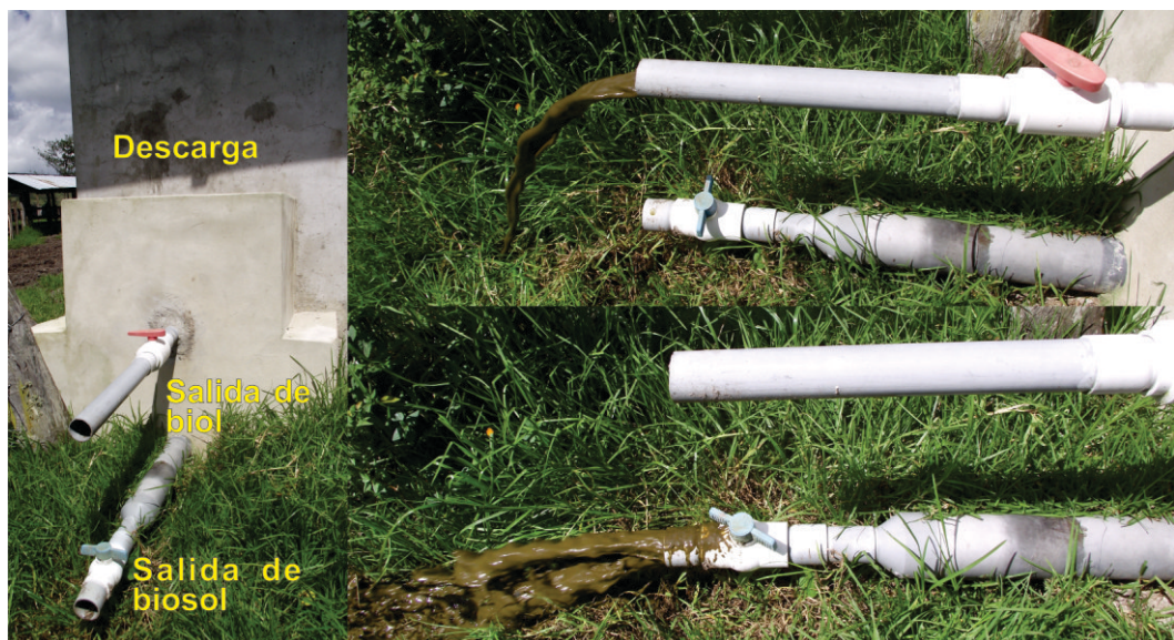
Figura 82. Extremo de descarga del biodigestor instalado en Pomacochas, Amazonas-Perú. Descarga de biol y de biosol.
