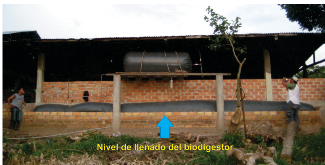
Figura 93. Biodigestor instalado en Granja Ganadera de Calzada.
