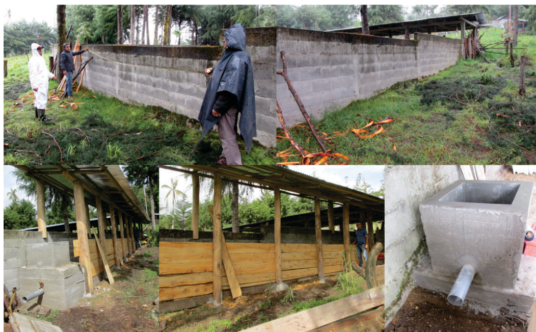
Figura 55. Infraestructura para instalar el biodigestor constituida por la poza de salida de biol, tubería de fondo para salida de biosol, poza de 10 m de largo hecha de madera para el biodigestor y poza de carga o alimentación del biodigestor; en Puma Hermana, Amazonas.
