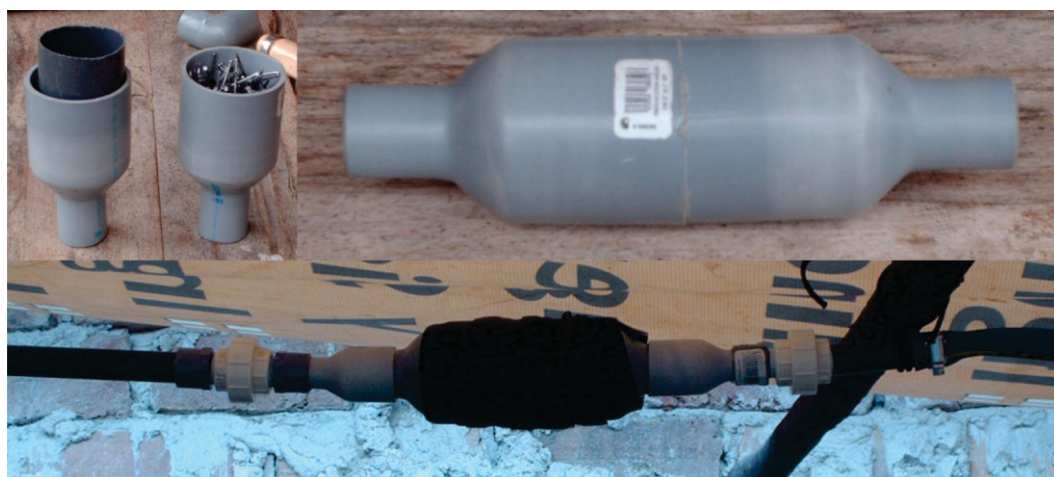
Figura 37. Armado e instalación del cartucho relleno con esponja de hierro en los extremos y clavos en el cuerpo, para eliminar el H_2S del biogás.
