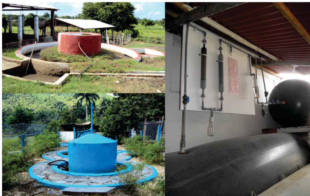
Figura 20. Gasómetros fijo (rojo), flotante (azul) y de geomembrana de PVC.
