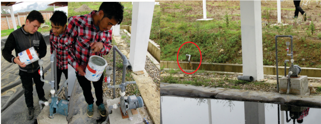
Figura 181. Cebado de la electrobomba para recircular biol en el BTLC y de la electrobomba para llevar biol al campo de cultivo.
