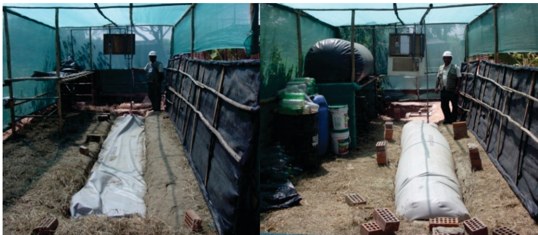
Figura 96. Biodigestor instalado en la UNT.
