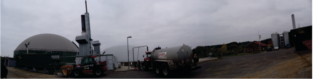
Figura 146. Panorámica de la planta de biogás de Jühnde. A la derecha están los tanques de almacenamiento de agua caliente.
