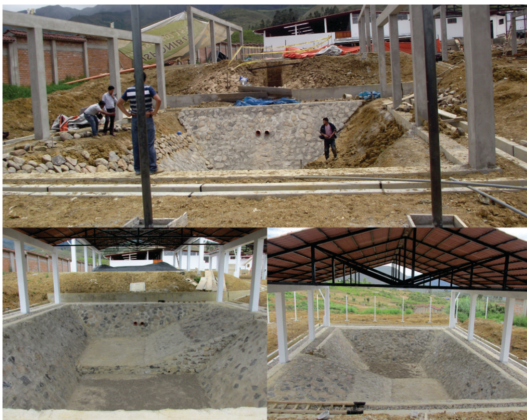
Figura 170. Cámara para secado de lodos de fondo del digestor.
