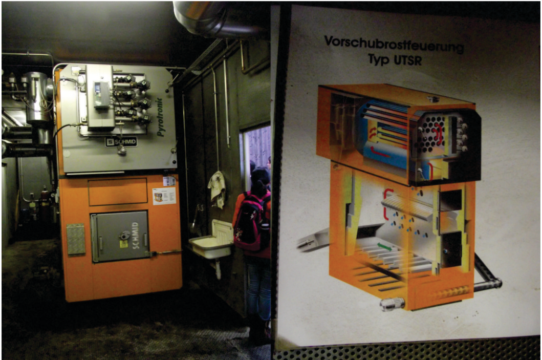
Figura 153. Caldera cuyo combustible son chips de madera, para calentar el agua para calefacción.
