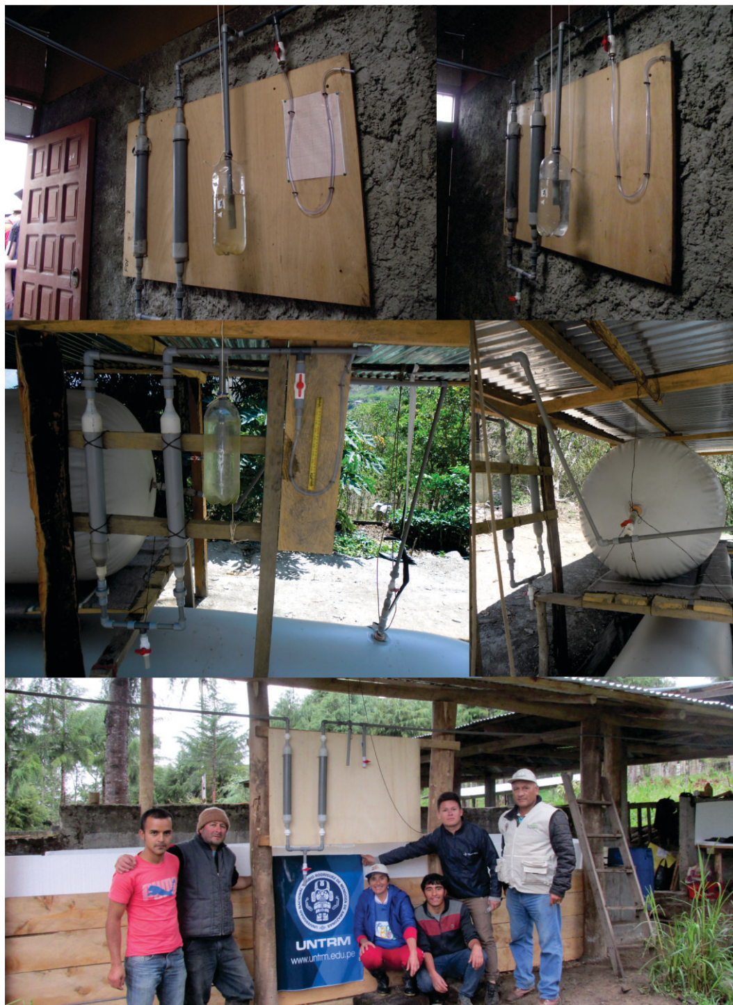
Figura 76. Tablero de control y purificación del biogás instalado en Pomacochas, en Providencia y en Puma Hermana, Amazonas-Perú.
